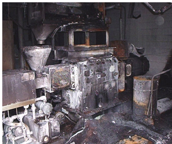
La extrusora se vio totalmente afectada por el fuego que se generó por un problema eléctrico
